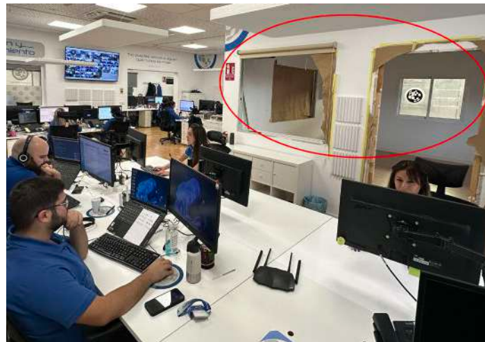
Zona laboral en obras para quince puestos de trabajo de nueva creación.
